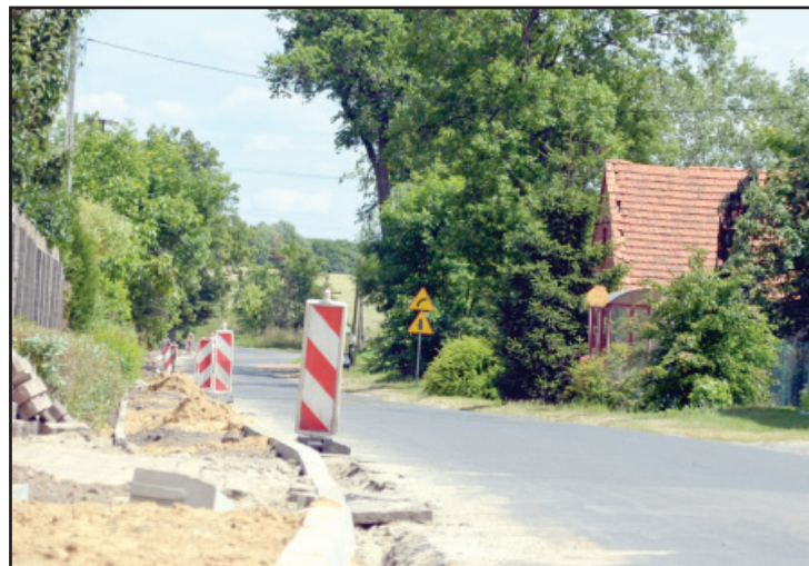
W Gniewowie przebudowany zostanie istniejący chodnik. Koszt przebudowy drogi Gniewowo-Wonieść wyniesie 713 648 złotych.
